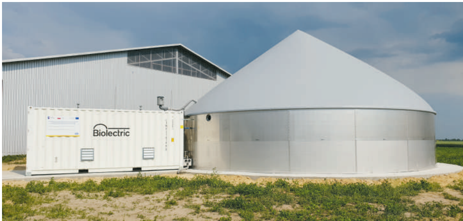
Jedna z 30 mikrobiogazowni o mocy 33 kW pracująca przy gospodarstwie rolnym
